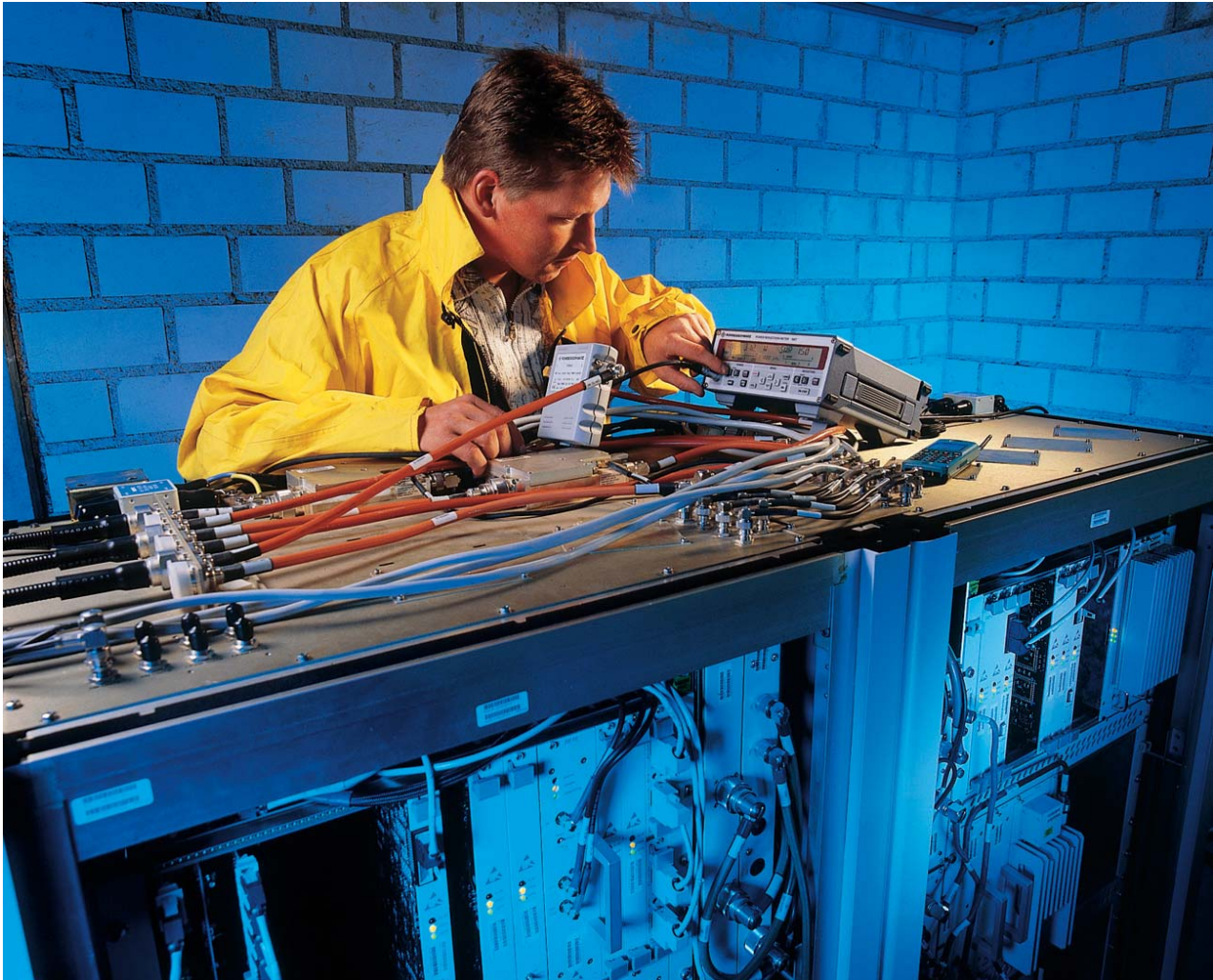
R&S NRT bei der Installation einer Mobilfunk-Basisstation (Foto 42667)
